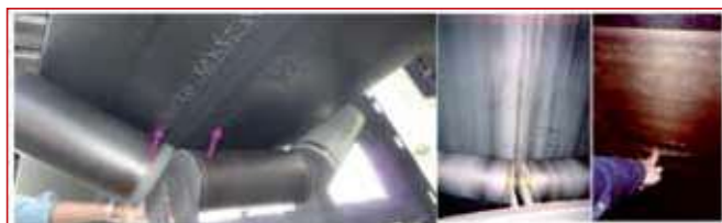
Rys. 17 Przykłady zmian grubości i uszkodzeń powierzchni okładki nośnej [28]
